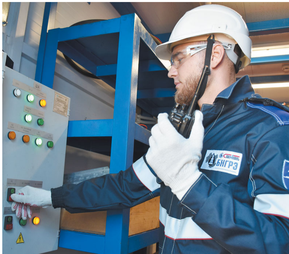
Помощник бурильщика 5-го разряда ООО «БНГРЭ» Артем Райш запускает систему пожаротушения при проведении УТЗ «Пожар» на КП-38
